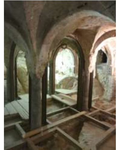
Fig.21: Posa in opera del "gazebo" strutturale e graticcio a sostegno della pavimentazione vetrata.
