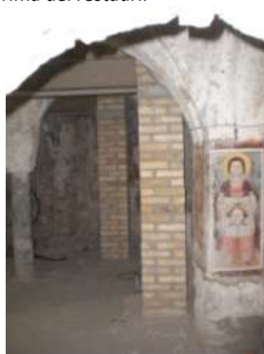
Fig.9: I nuovi pilastri in muratura e le travi di rinforzo in "affiancamento" alle strutture originarie della cripta.
