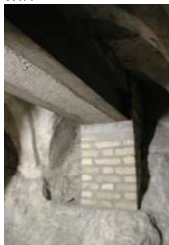
Fig.8: I nuovi pilastri di rinforzo inseriti negli anni '30 appoggiano direttamente sulla roccia della cripta.
