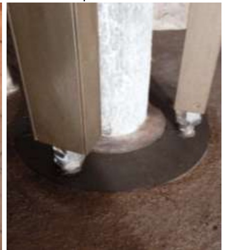
Fig.18: Fondazione di appoggio del "gazebo strutturale" in corrispondenza delle colonnine in pietra: piastra di appoggio inox.
