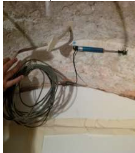
Fig.14: Il sistema di monitoraggio delle fessure, mantenuto in opera prima, durante e dopo i lavori.
