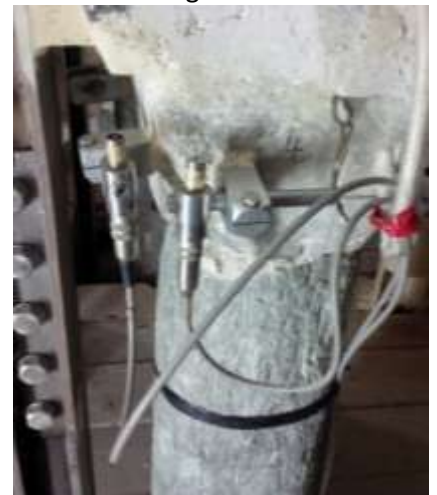
Fig.15: Il sistema di strain gauges, mantenuto in opera prima, durante e dopo i lavori.
