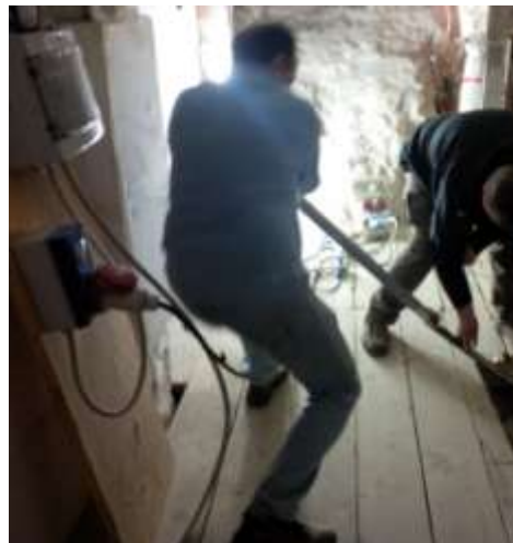
Fig.23: La fase di "messa in forza" del sistema con chiave dinamometrica. Gli strain gauges consentono di misurare in tempo reale il carico trasferito dalle colonnine in pietra alla struttura in acciaio.
