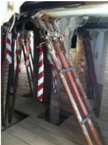
Fig.16: Il sistema di puntellazione provvisoria mantenuto in opera per tutta la durata delle lavorazioni.
