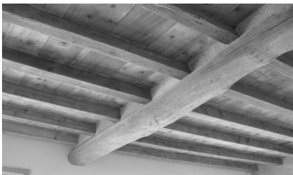
fig. 1 Cascina Ronchi a Sulbiate (MB). Travi rinforzate con metodo tradizionale e occlusione dei vuoti tra i travetti
