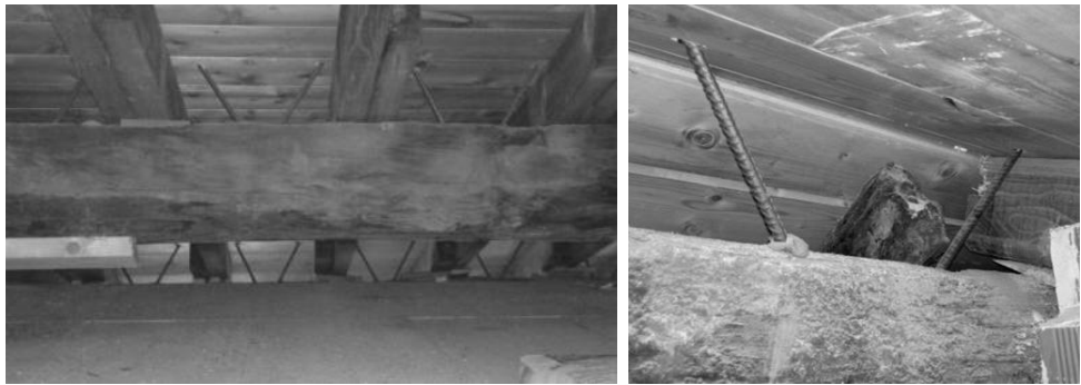
figg. 9a; 9b - Palazzo Scotti a Laino Consolidamento delle travi di copertura
